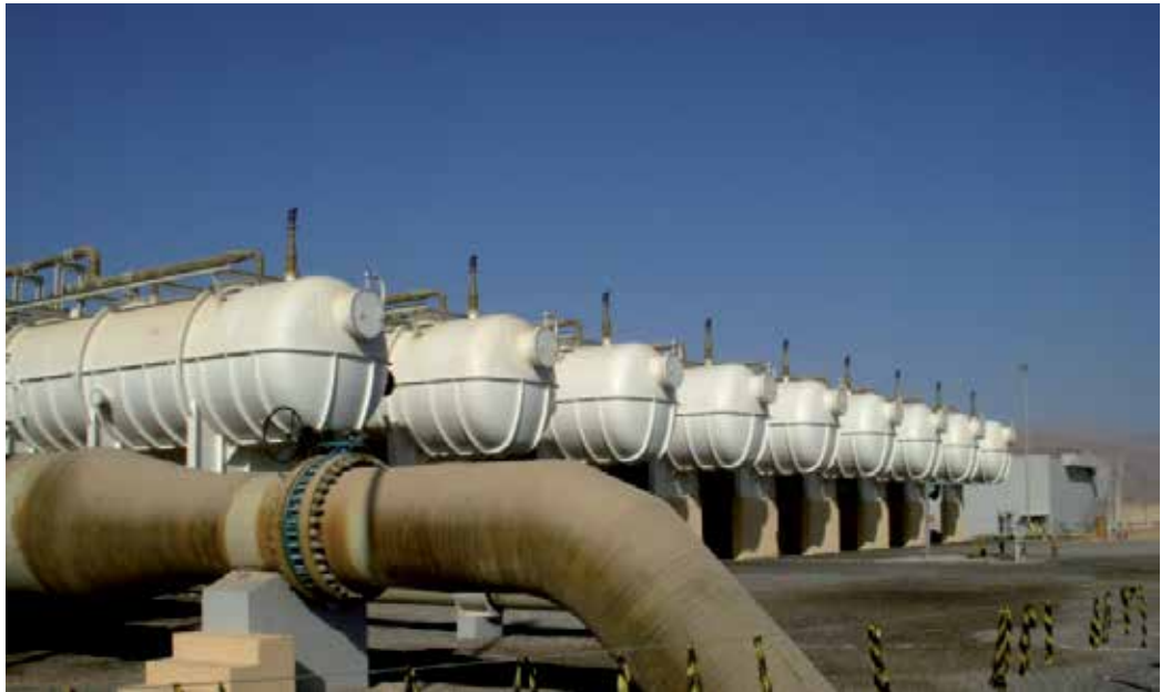
Fig. 24. Single media Pressure filters (Oman Sur desalination Plant)
